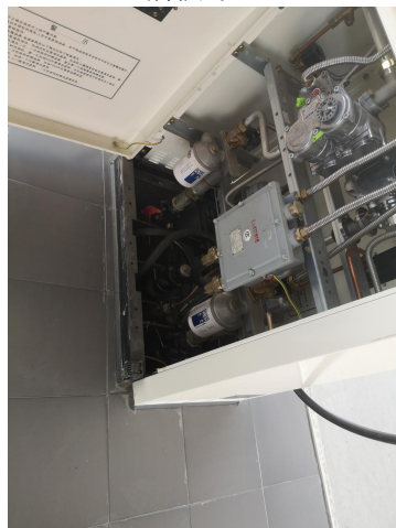
油气回收装置
