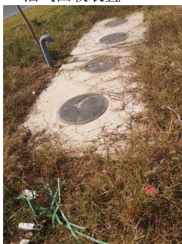
沉淀池及水封井
