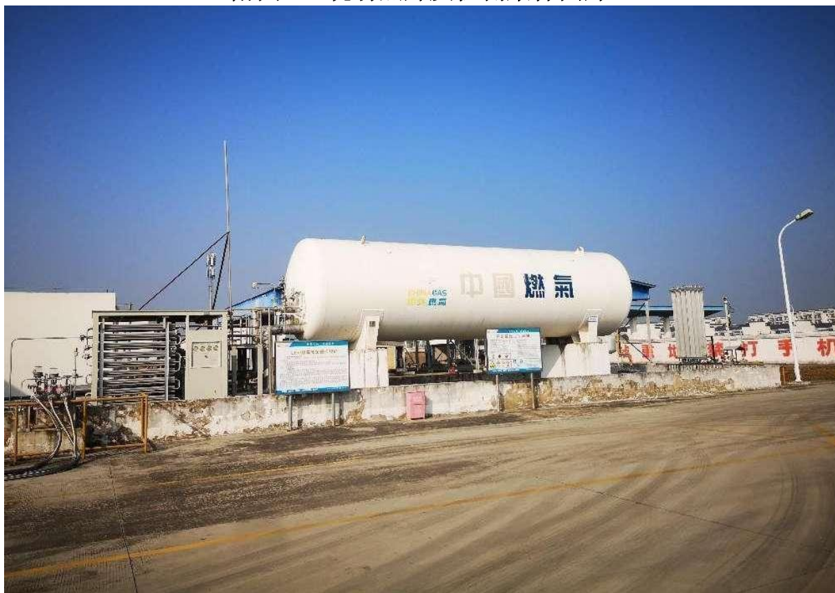
LNG 60 立方卧式储罐
