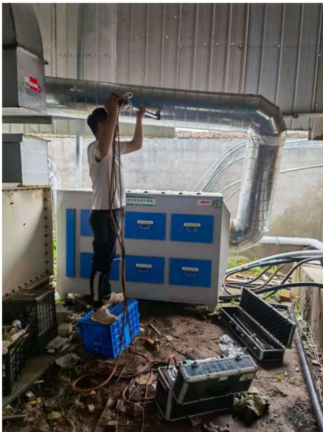
有组织废气进口检测采样
