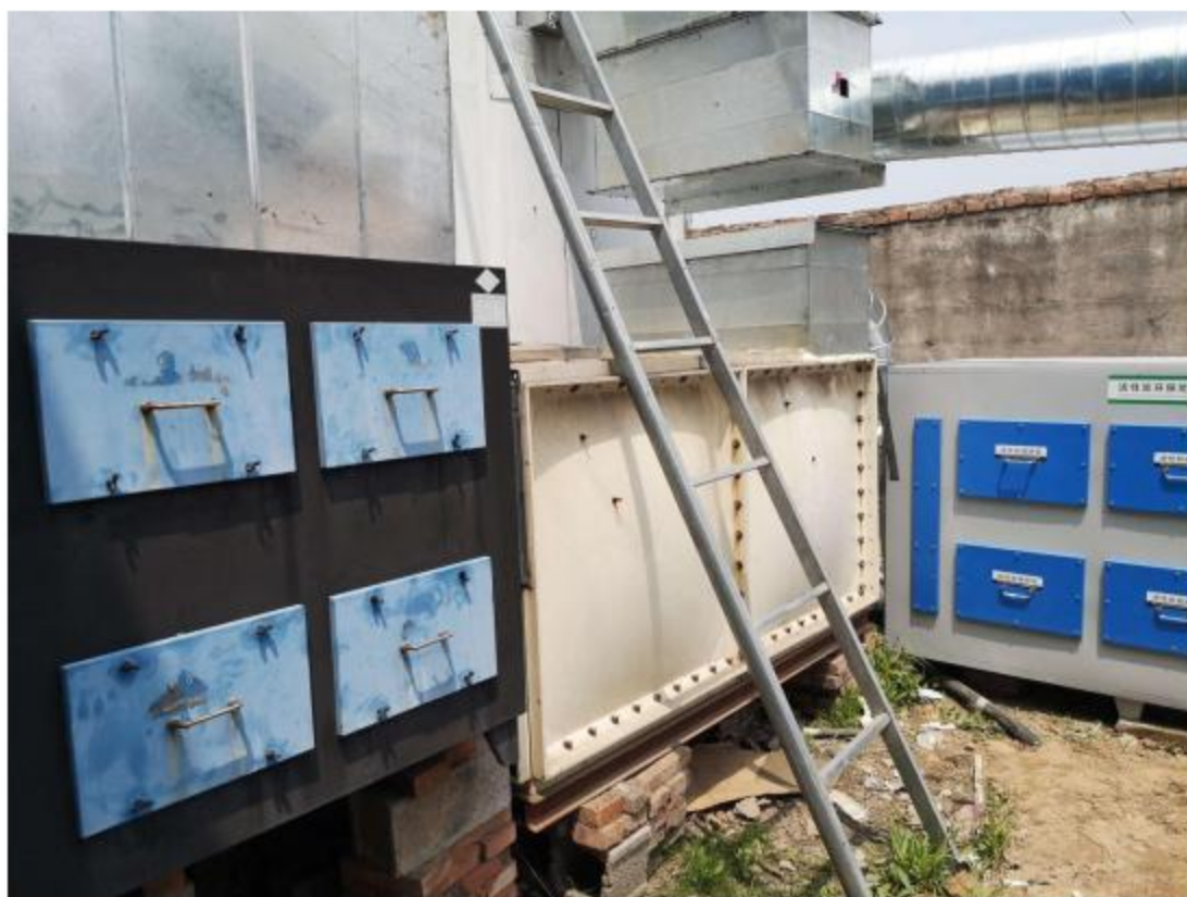
废气处理装置
